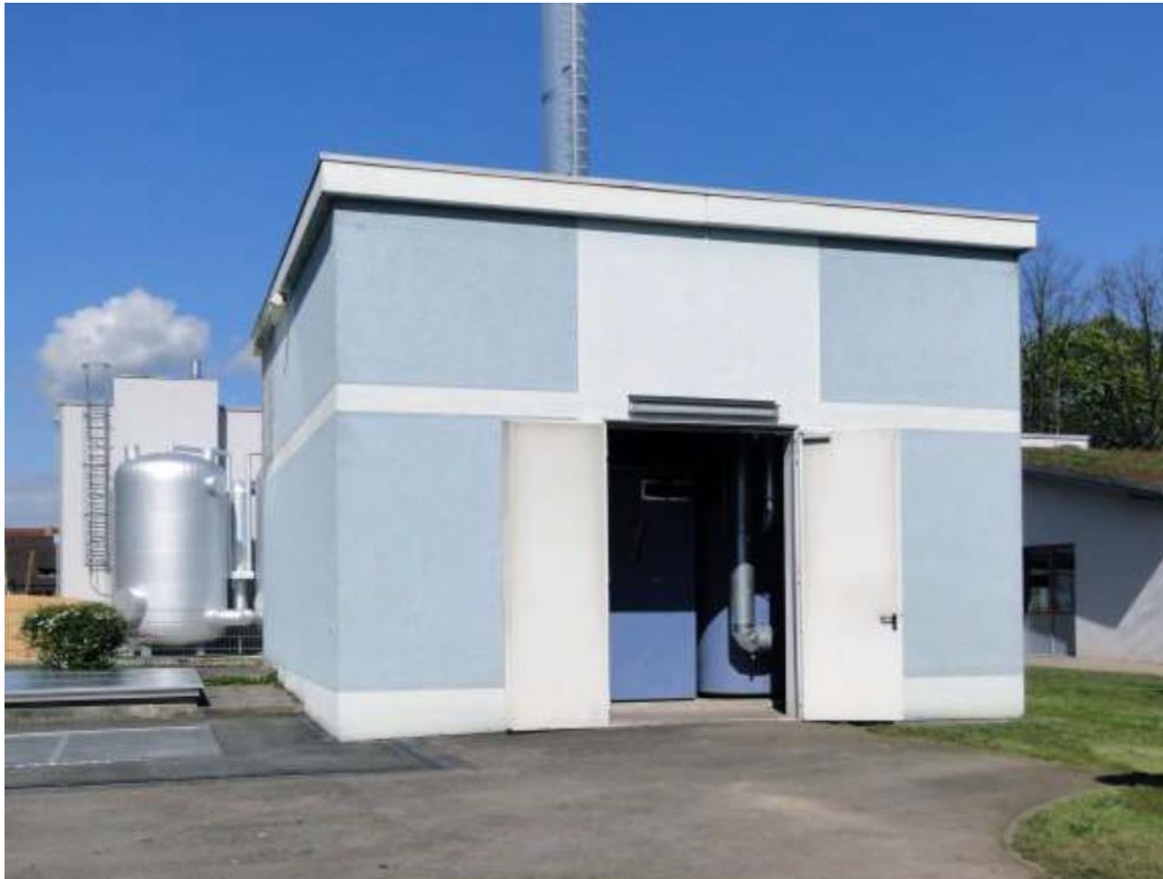
Foto: Nahwärme Teningen
